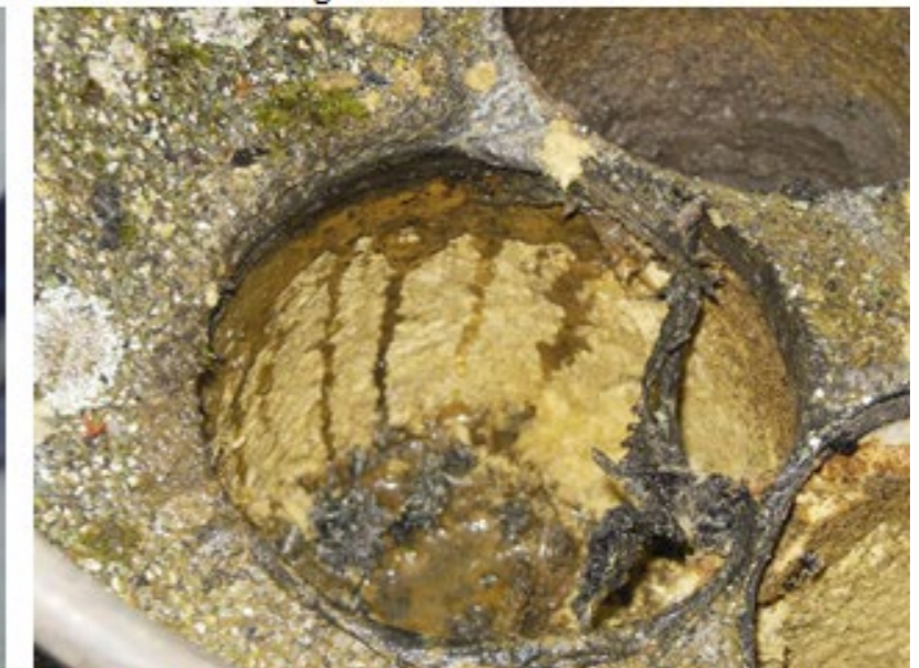
Foto 6: Vergroten boring 1 - aflopend water afkomstig tussen isolatie en dakdichting
