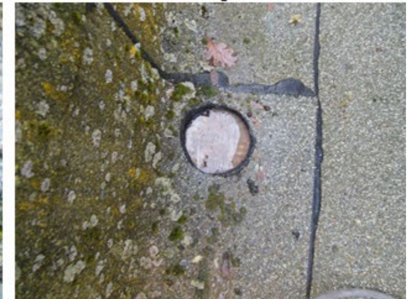
Foto 4: Boring 2 - waterdruppels tussen isolatie en dakdichting
